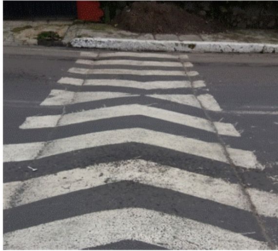
Imagen 2. 9. Balizamiento destinado al transeúnte en condiciones aceptables (Av. Puerto México)
