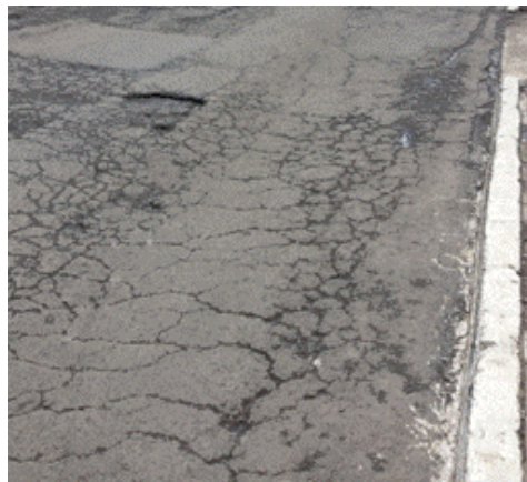
Imagen 2. 3. Carpeta asfáltica en condiciones malas (Calle Ocampo).
