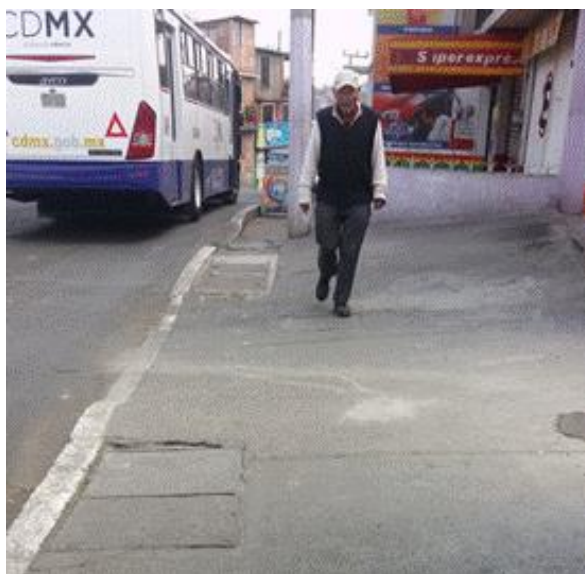
Imagen 2. 14. Banqueta en condiciones regulares. (Av. Puerto México)
