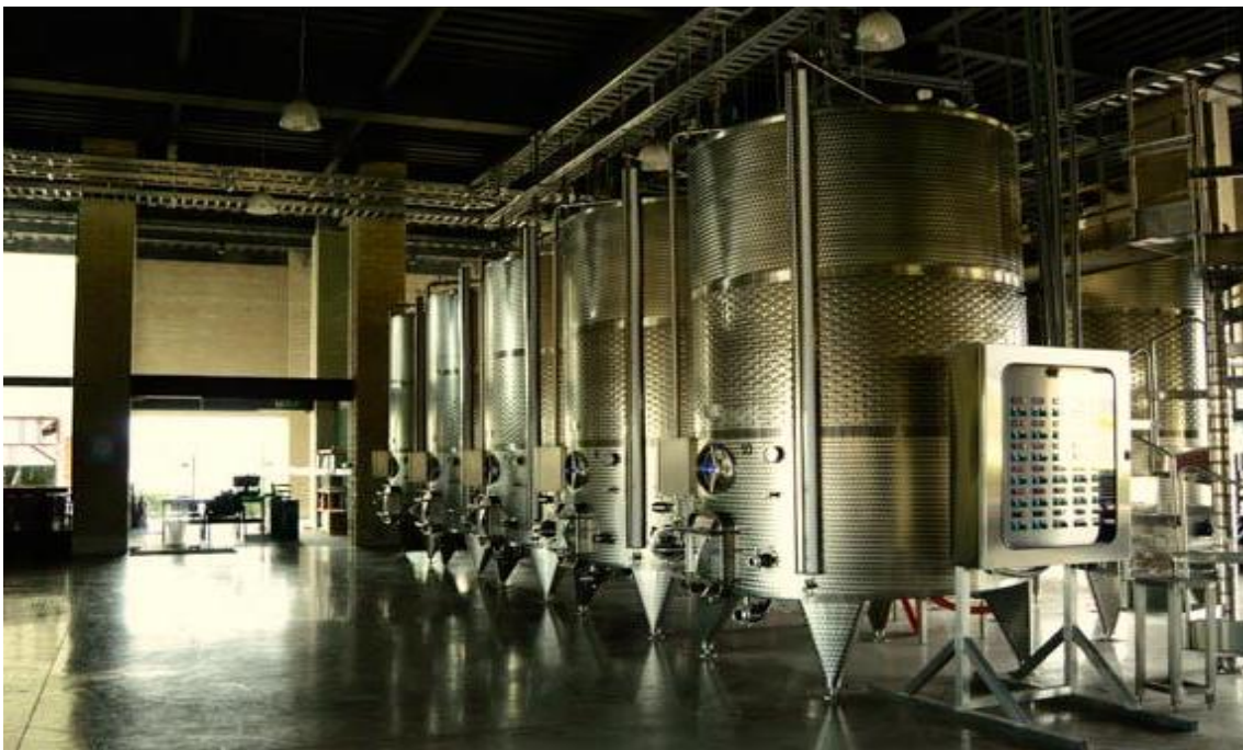
Sala de tanques de fermentación de Bodegas de Cote
