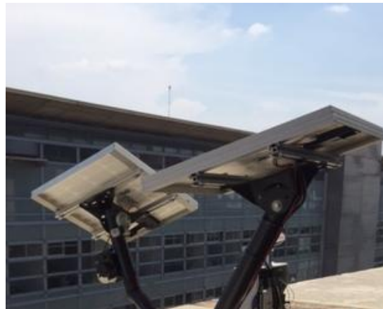
Figura 4.2 Paneles FV montados para el bloque de generación
