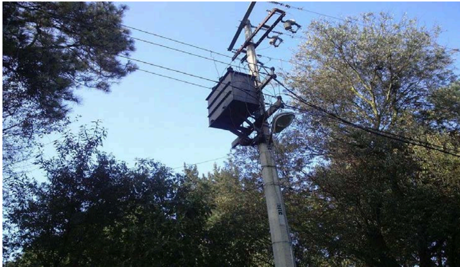
Foto no. 12. Transformador de luz. Fuente propia, tomada el 6 de Julio de 2014.
