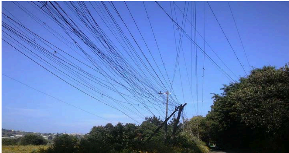
Foto no. 13. Cables colgados al transformador de luz. Fuente propia, tomada el 6 de Julio de 2014.
