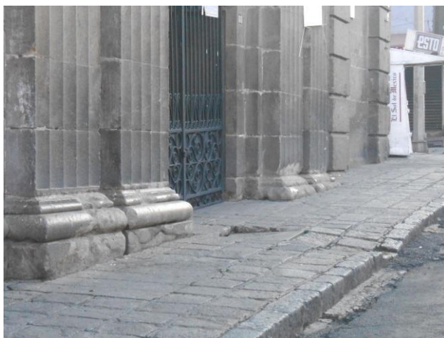
Fig. 29a. aspecto de hundimiento en fachada sur
