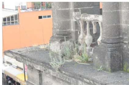
Fig. 32c. daño en cornisa y balaustrada exterior
