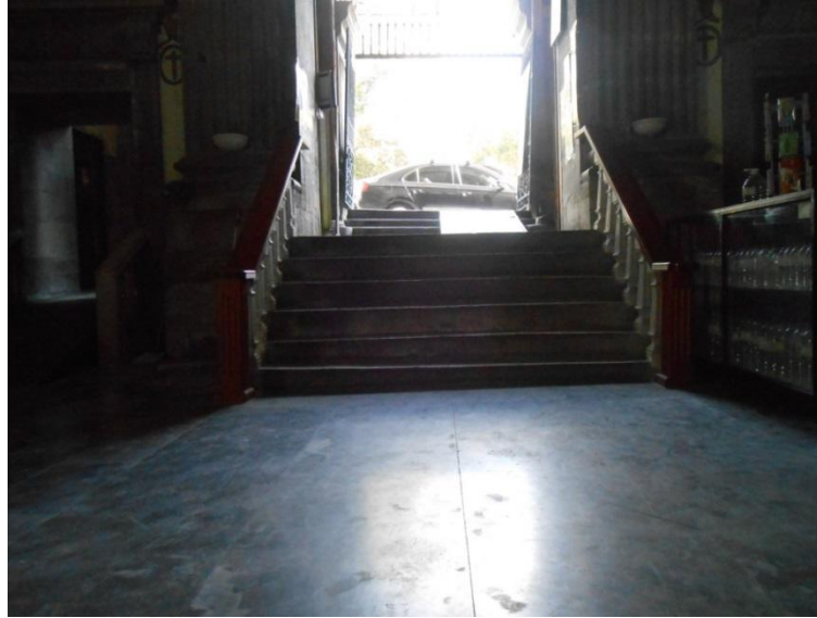
Fig. 29c. hundimiento del interior del templo en relación al nivel de calle del exterior
