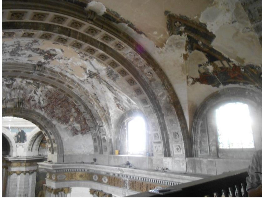
Fig. 28a. humedad en bovedas (interior del templo)
