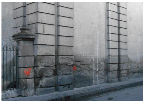
Fig. 32d. daño en muro exterior del templo
