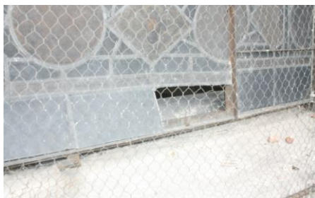
Fig. 32b. daño en vitrales
