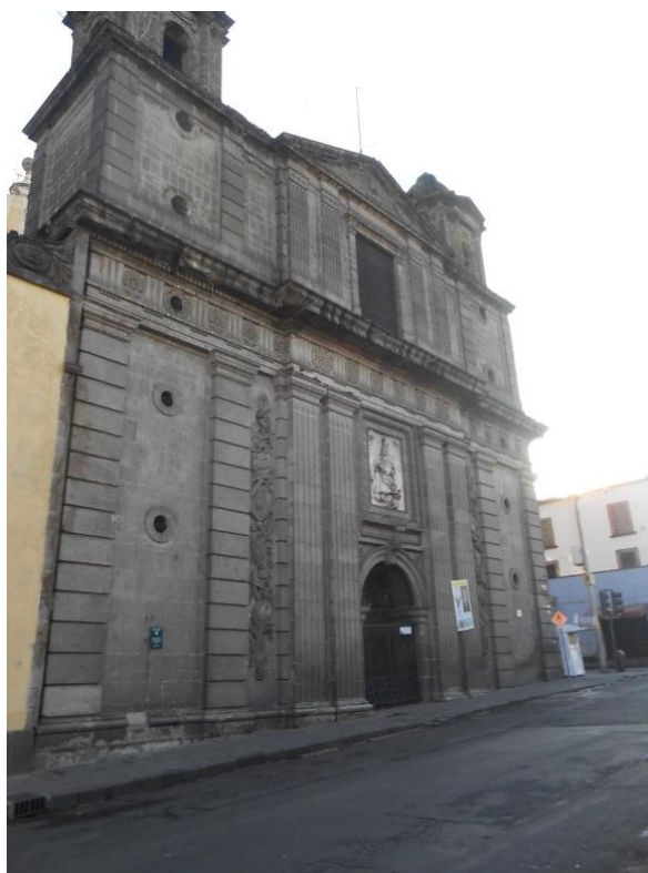
Fig. 29b. vista general de hundimiento en fachada sur
