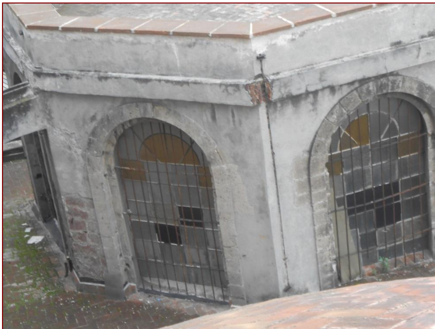
Fig. 32a. daños en ventanas
