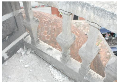
Fig. 32e. daño en balaustrada exterior
