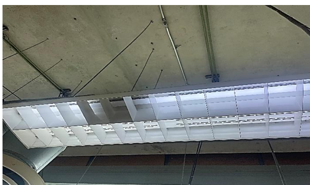
Figura 17. Luminaria con lámpara sin operar correctamente
