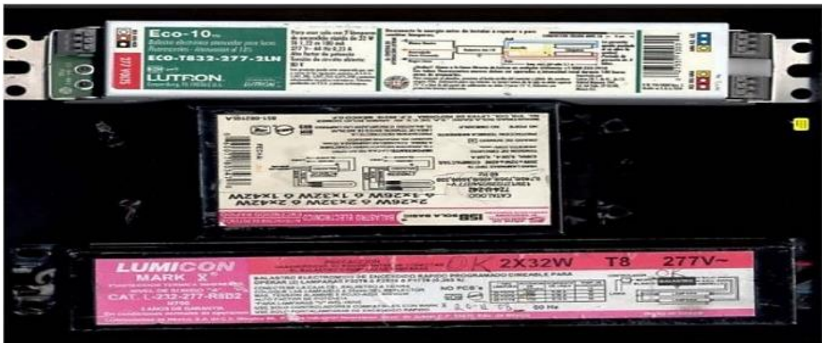
Figura 13. Modelos de Balastos instalados en el sistema fluorescente del edificio A Fuente: (PEUACM, 2009)
