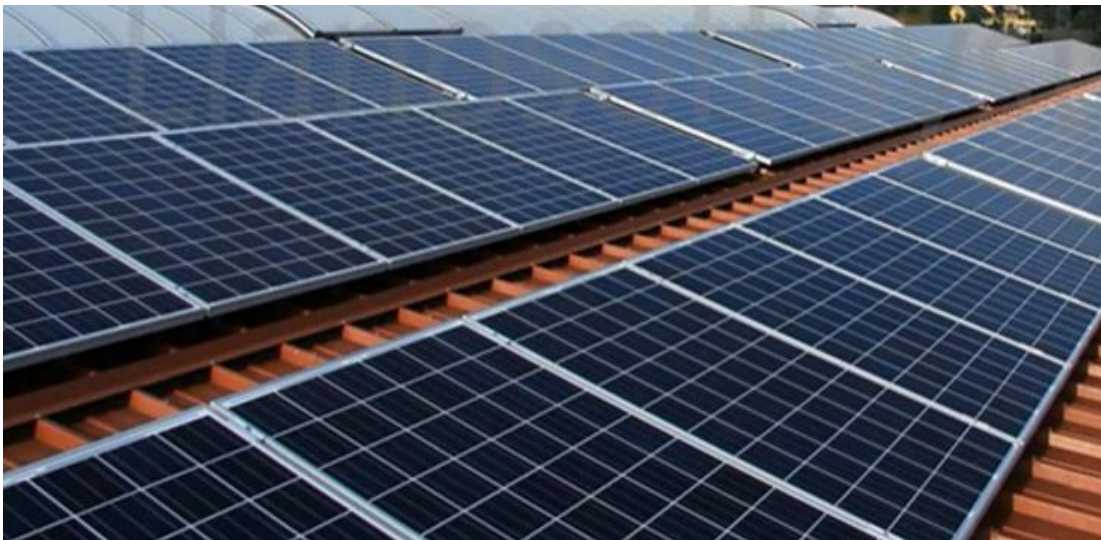
Ilustración 9. Cadenas o string de módulos fotovoltaicos (Energy, 2021)
