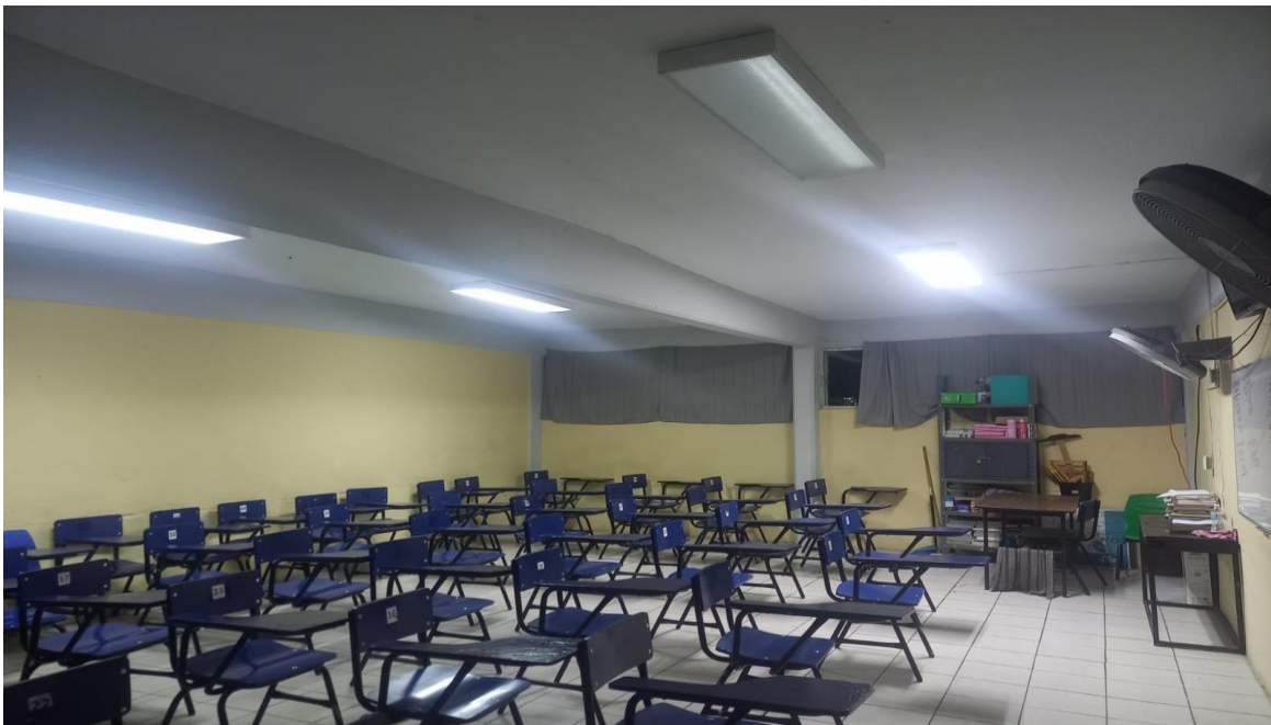
Figura 47 Salón de clases con luminarias dañadas y bajo flujo luminoso (fuente: elaboración propia).
