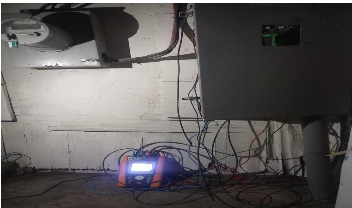
Figura 43 Analizador de redes PQA 824 POWER QUALITY ANALYZER (fuente: elaboración propia).
