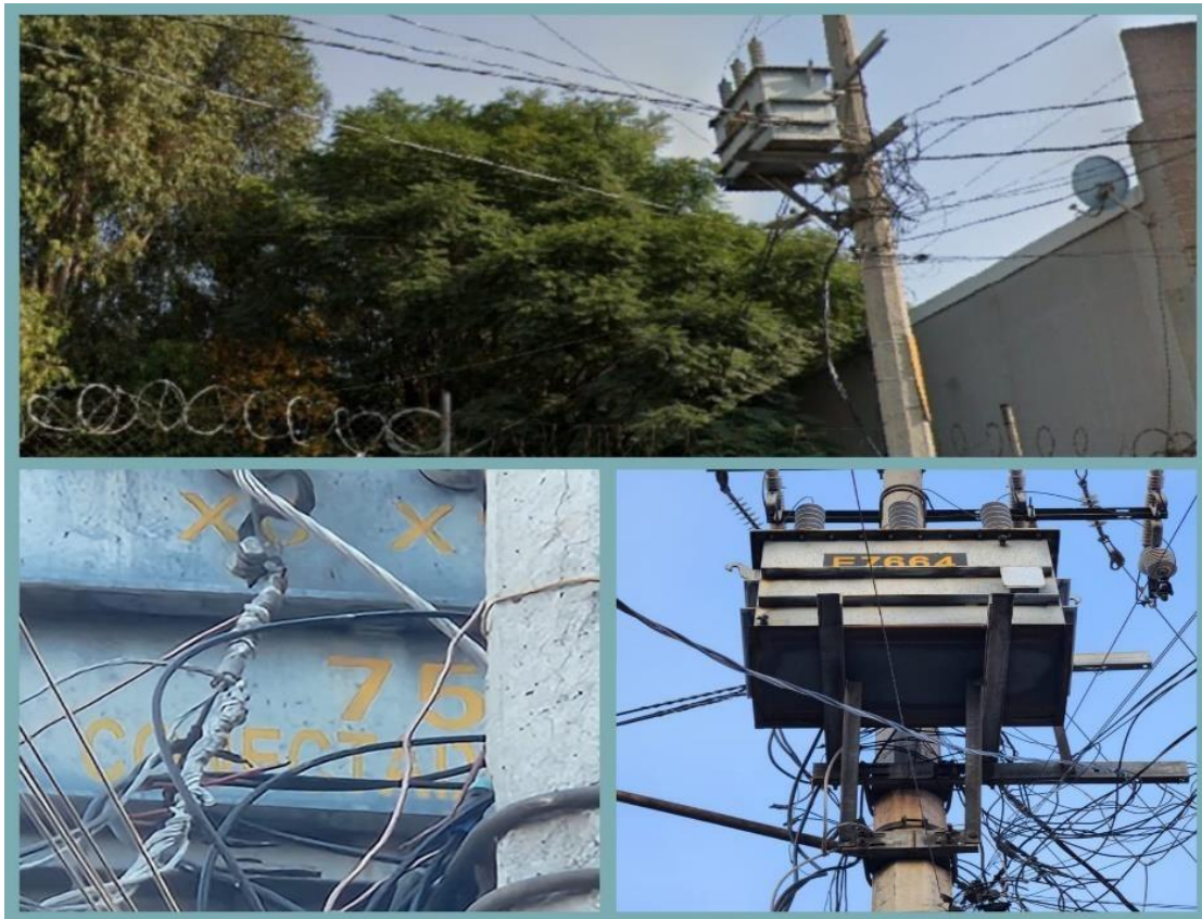
Figura 41 Transformador tipo poste (fuente: elaboración propia).
