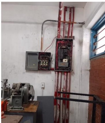
Figura A.1.17 Tablero de control en mal estado del salón de máquinas.
