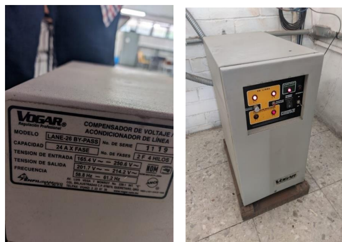
Figura A.1.28. y A.1.29. Regulador de aula de cómputo.
