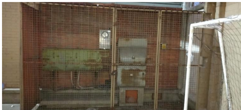
Figura A.1.21. Posible Subestación Eléctrica.
