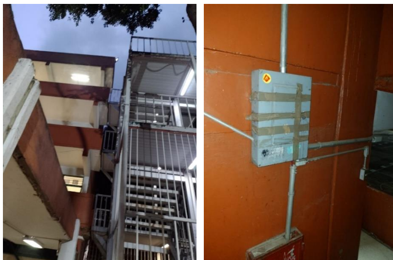
Figura A.1.12. y A.1.13. Escaleras de lado derecho y tablero sin iluminación en escaleras izquierda del edificio C.
