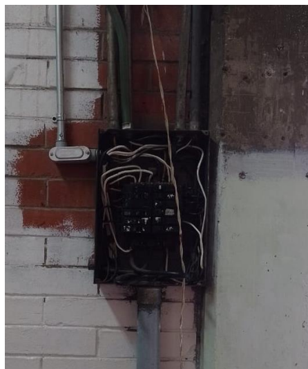
Figura A.1.18. Tablero del gimnasio en el edificio D.
