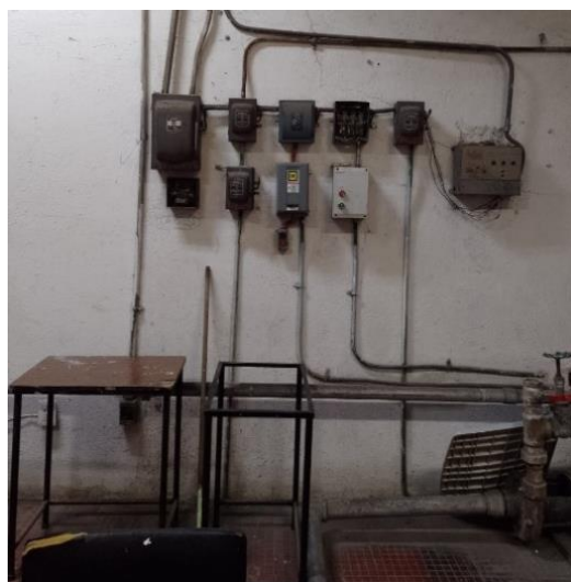
Figura A.1.22. Tablero de control de intendencia, en mal estado.
