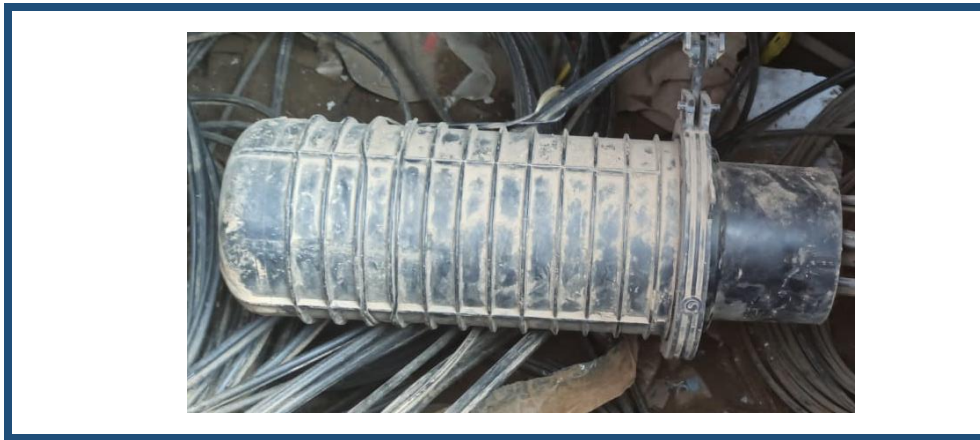
Figura 24: Cierre de empalme 450bs.
