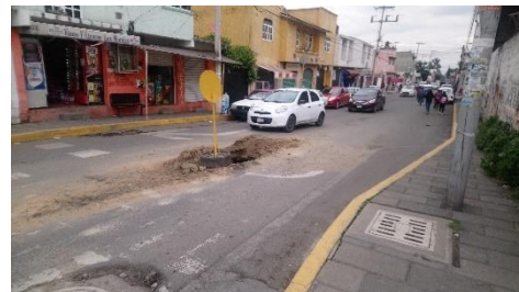
Foto: Bache en avenida Cuauhtémoc, una de las arterias principales del pueblo. 11-10-2022
