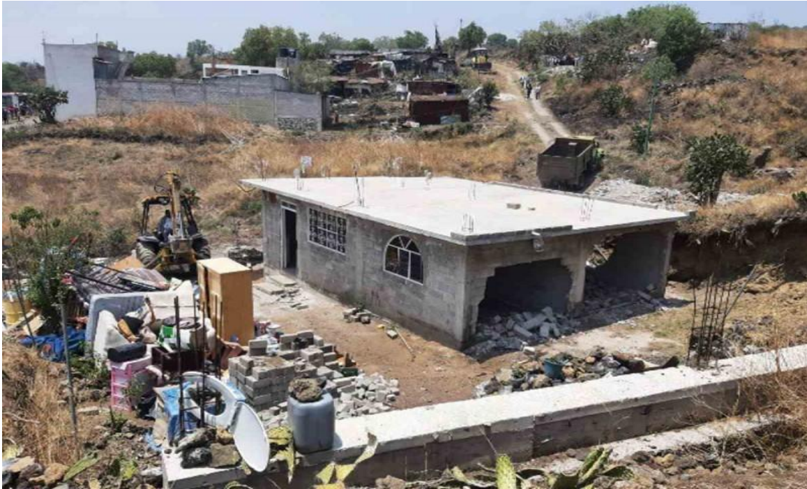
Imagen 4. Vivienda en demolición como parte de la recuperación del predio El Jarro y Prolongación Barranca , 2022
