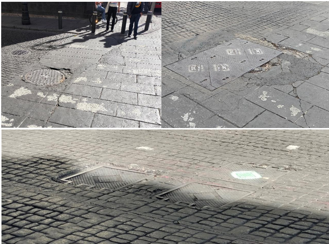
Figura 4.7. Afectaciones físicas en Isabel la Católica esq. Rep. del Salvador.
