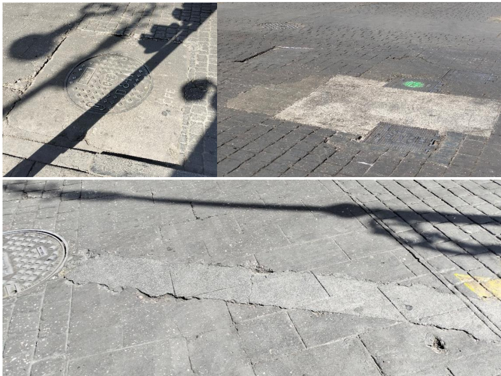
Figura 4.13. Afectaciones físicas en Isabel la Católica esq. Venustiano Carranza.
