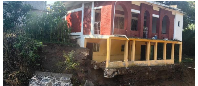
Figura 31 Daños estructurales a Viviendas en Tejupilco
