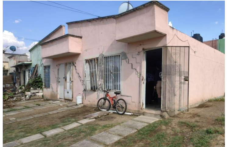
Figura 18 Casa con Daños estructurales, Chalco
