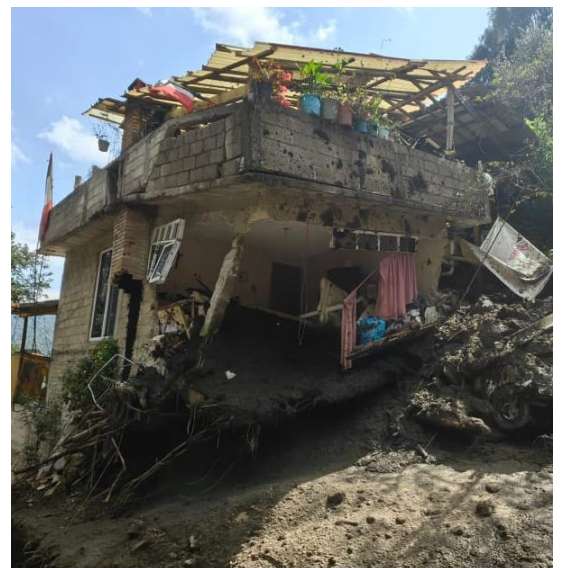
Figura 33 Daños Estructurales en Jilotzingo
