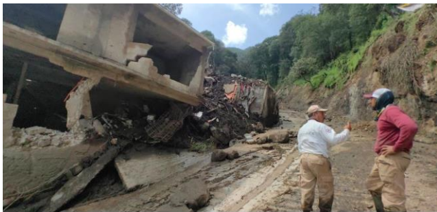
Figura 36 Daños Estructurales en Jilotzingo
