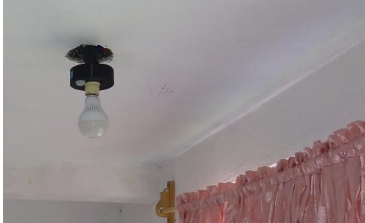
Figura 4.5: Captura de la instalación del prototipo en una sala de un espacio doméstico.
