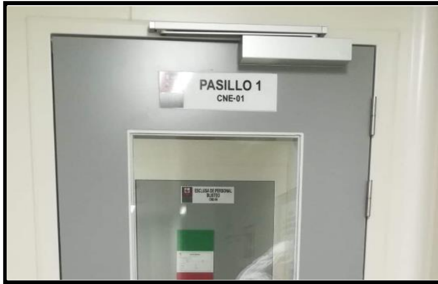
Figura 11. Instalación de la cerradura electromagnética en una puerta
