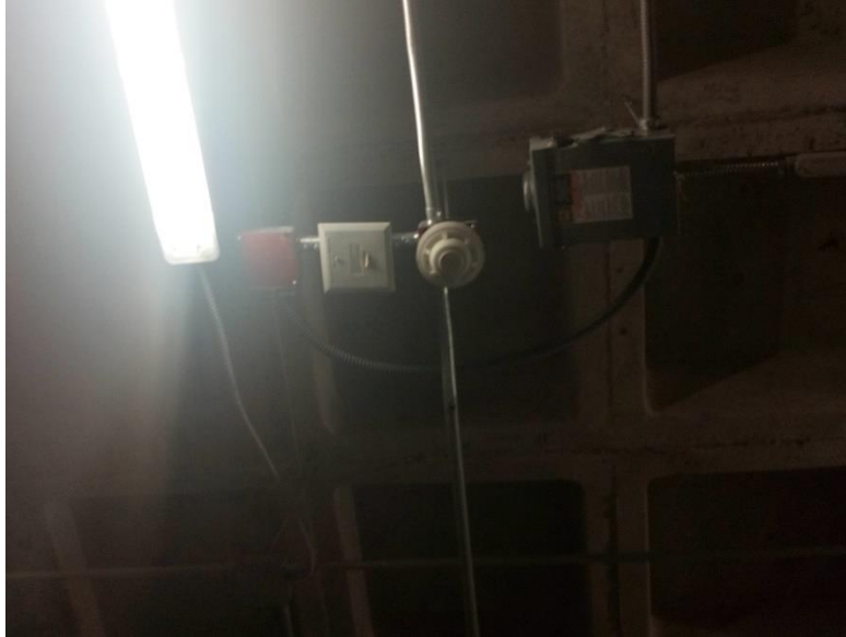
Figura.28 Muestra arreglo del módulo relevador hacia el interruptor de cuchillas del arrancador. Elaboración propia.
