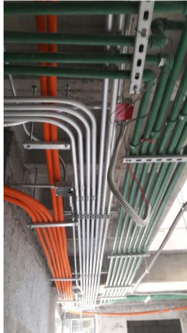
Figura.50 Muestra cama de tubería galvanizada para interfonía. Elaboración propia.
