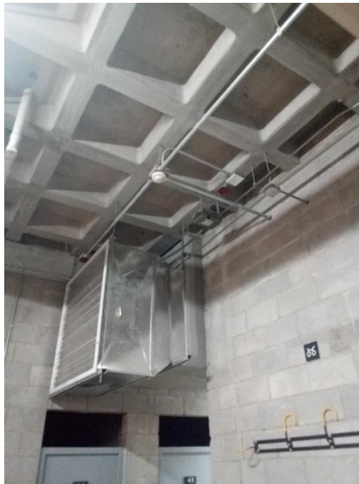
Figura.27 Muestra canalización y colocación de equipo hacia el extractor de aire. Elaboración propia.
