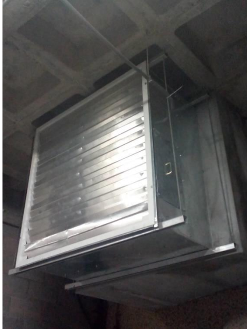
Figura.25 Muestra extractor de aire instalado. Elaboración propia.
