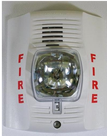
Figura.8 Alarma con estrobo P2W.
