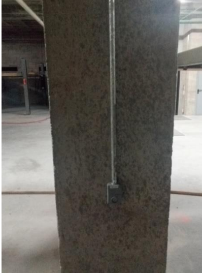
Figura.26 Muestra detector de C.O colocado sobre columna. Elaboración propia.
