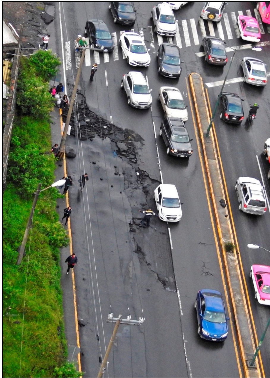
Figura 45 Grieta Generada por Corriente de Agua en la Ctra. Picacho Ajusco Fuente: Elaboración propia, fotografía capturada en Ctra. Picacho Ajusco e intersección Sinanche.
