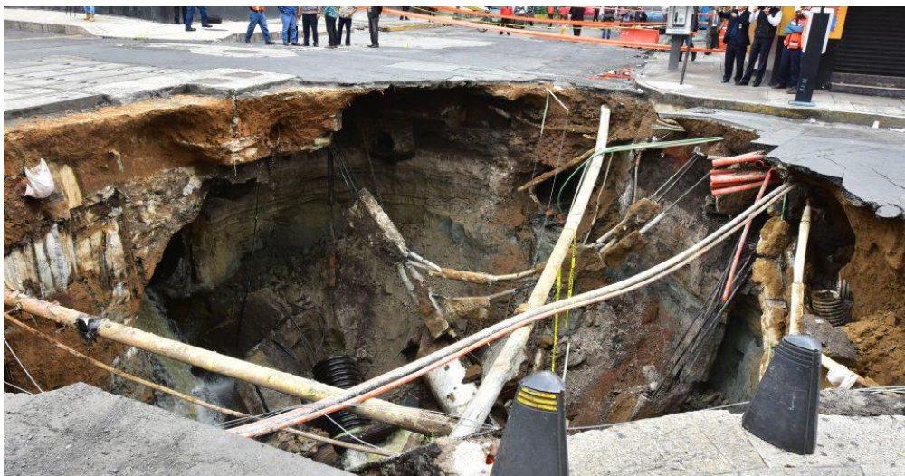
Imagen 7. Socavón por hundimiento en la colonia La Paraíso. Tomado de revista Proceso
