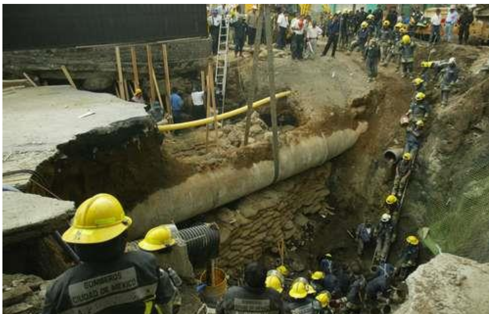
Imagen 8. Fracturas y hundimientos del suelo en Iztapalapa por extracción extensiva de agua subterránea. Tomado de La Jornada (2010)
