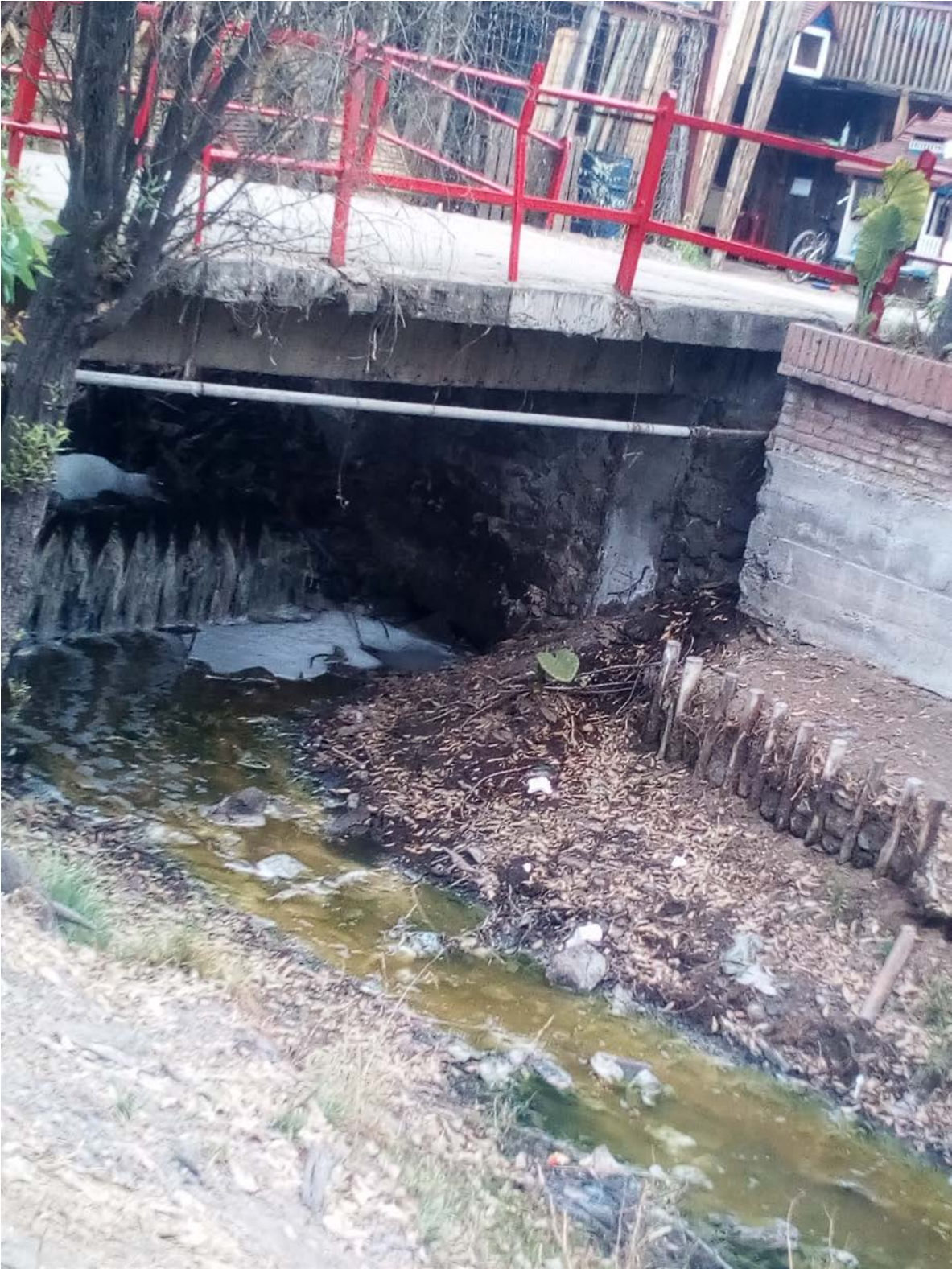
Tubos de cañería generando gran cantidad de espuma en el interior del canal, en Av. Nuevo León. Foto tomada en el mes de Abril del 2019.
