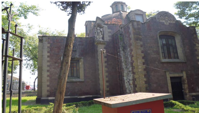
Ilustración 9. Fachada trasera lado izquierdo, el tezontle y cantera de los muros presentan daños por humedad y crecimiento de flora, Capilla Británica. Foto: Jesús A. Nava Martínez
