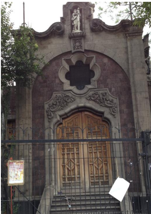
Ilustración 11, Puerta principal, presenta deterioro y caída de Barniz, Capilla Británica. Foto: Jesús A. Nava Martínez.
