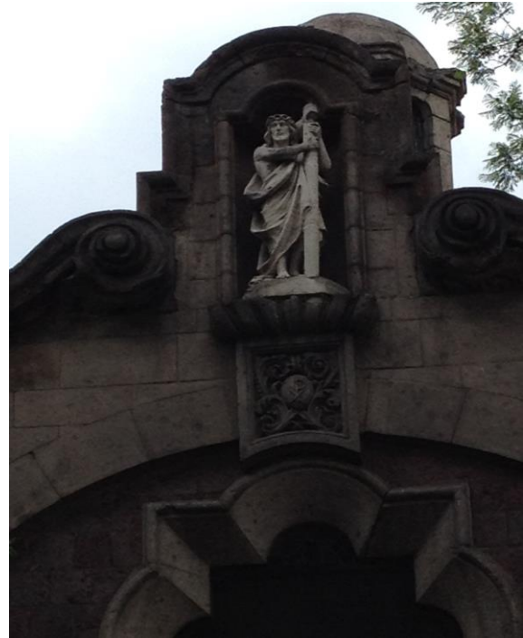
Ilustración 8, Fachada principal, imagen de Jesús con la cruz rota, la cantera presenta deterioró, Capilla Británica. Foto: Jesús A. Nava Martínez
