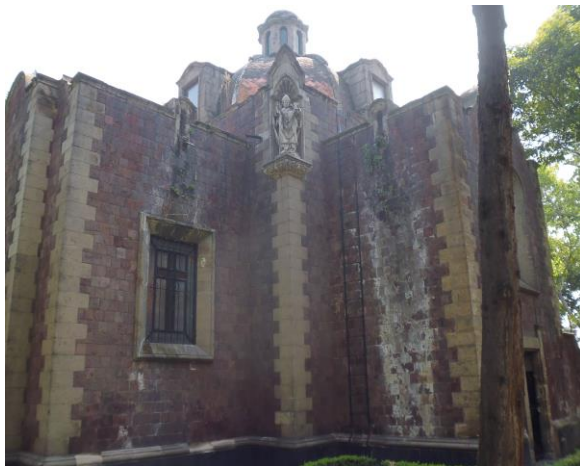
Ilustración 10. Fachada trasera lado izquierdo, el tezontle y cantera de los muros presentan daños por humedad y crecimiento de flora, Capilla Británica. Foto: Jesús A. Nava Martínez
