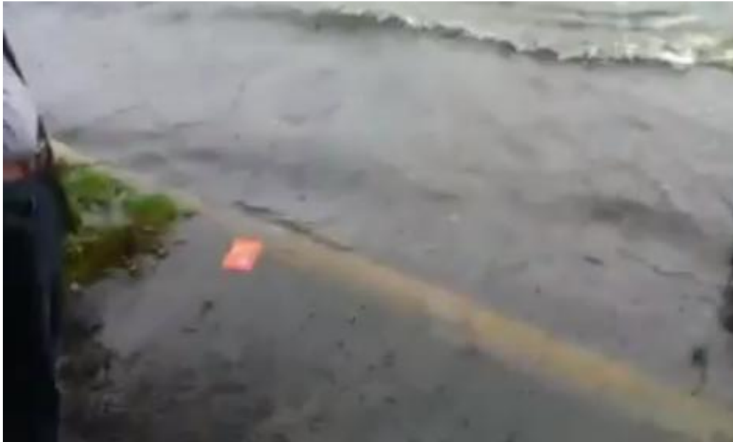
Figura A.1.9. Drenaje calle Providencia en época de lluvias. [1]
